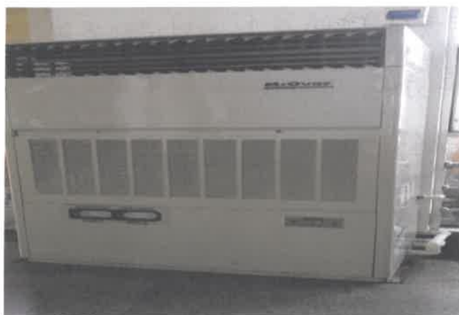
客运站场内固定式空调已正常使用
